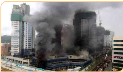
▲ 세종 주상복합 신축공사 중 화재 (’18.6.26. 사망3, 부상 37)
