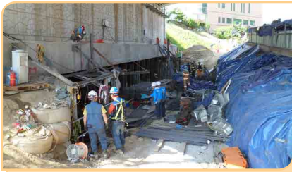
▲ 북선전철 교량 하부보강 중 LPG폭발 (’16.6.1. 사망4, 부상10)
