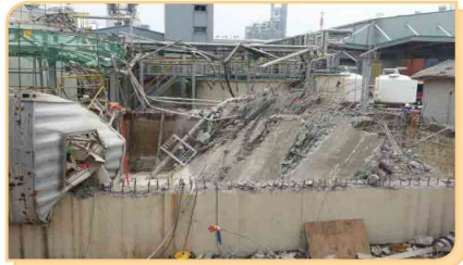
▲ 폐수 환경설비 구축공사 중 폭발 (’15.7.3. 사망6, 부상1)
