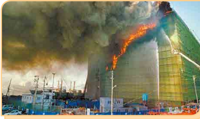
▲ 부산 냉동창고 신축공사 화재 (’98.10.29. 사망27, 부상16)
