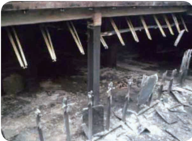
지수관 용접 중 하부 우레탄 보온판 화재로 4명 사상
