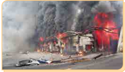
▲ 이천 물류 냉동창고 신축공사 화재 (’08.1.7. 사망40, 부상10)
